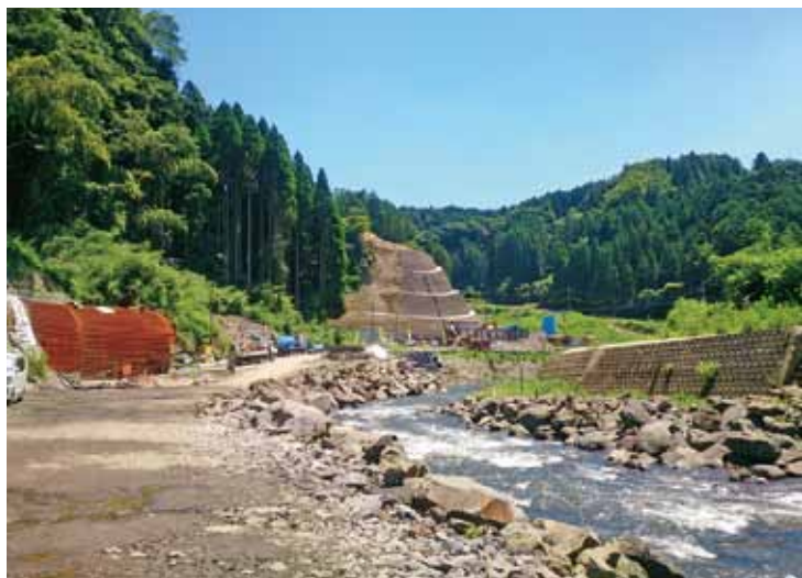
転流トンネル工事も進み、玉来ダム建設工事は本体着手に近づいています。7月28日に県事業評価監視委員会で「平成34年度完成」との見通しを県は発表。本体ができた後、水をためる試験などを経て完成します。
