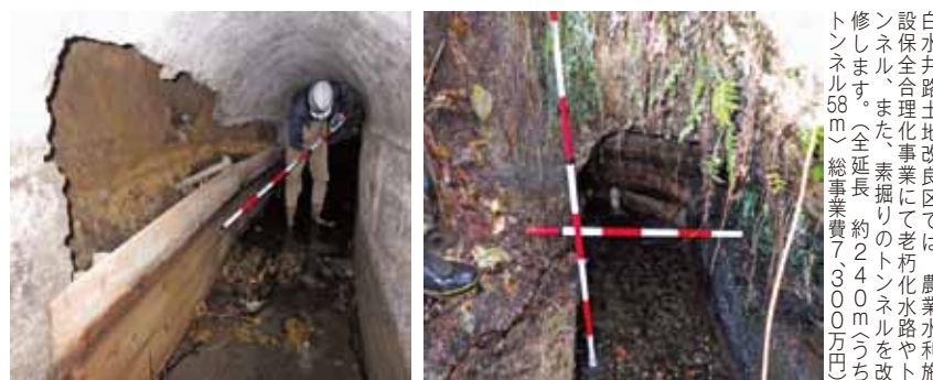
剥離脱落したトンネル側面の状況
