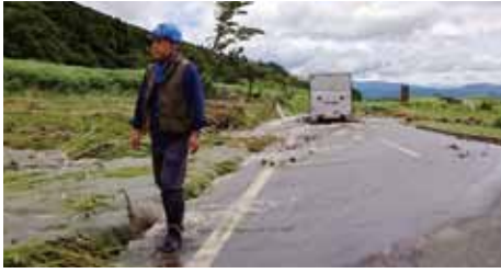
平成24年の7月豪雨で崩壊したところが、今回も崩壊。久住連山では治山事業を実施していましたが、完成する前にこの状態に。(7月8日)
